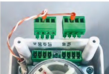
Фото 23. Подключение проводного выключателя
