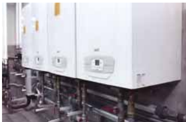
Общежитие, г. Усть-Луга Общая мощность котельной - 300 кВт
