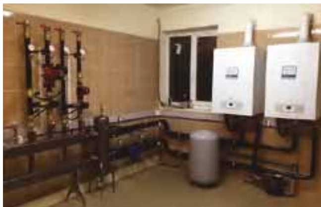
Автосервис, г. Москва Общая мощность котельной - 300 кВт
